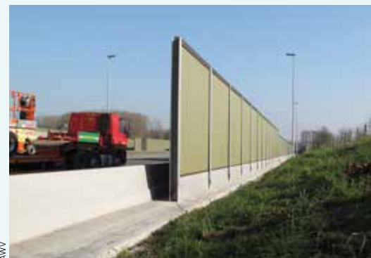
Het geluidsniveau dat bepaalt of geluidsschermen nodig zijn, wordt overdag gemeten.
