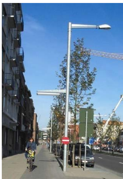
Foto 4.28 Lichtmast met twee lichtpunten - Leuven
